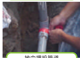
地中埋設管道
